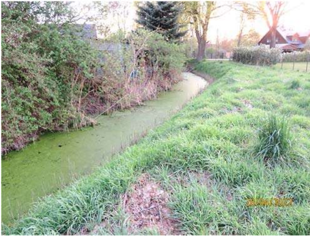
Elsgraben östlich der Straße Koppehof, Blick in Richtung West zur Straße Koppehof
