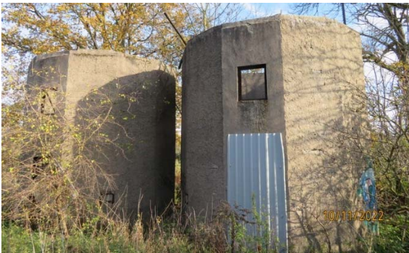
Landwirtschaftliche Silos im Bereich Koppehof - ruinös - versiegelt
