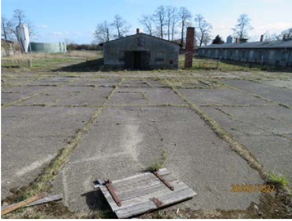
großflächige Versiegelungen (Beton) im Bereich der ehemaligen Sauenanlage
